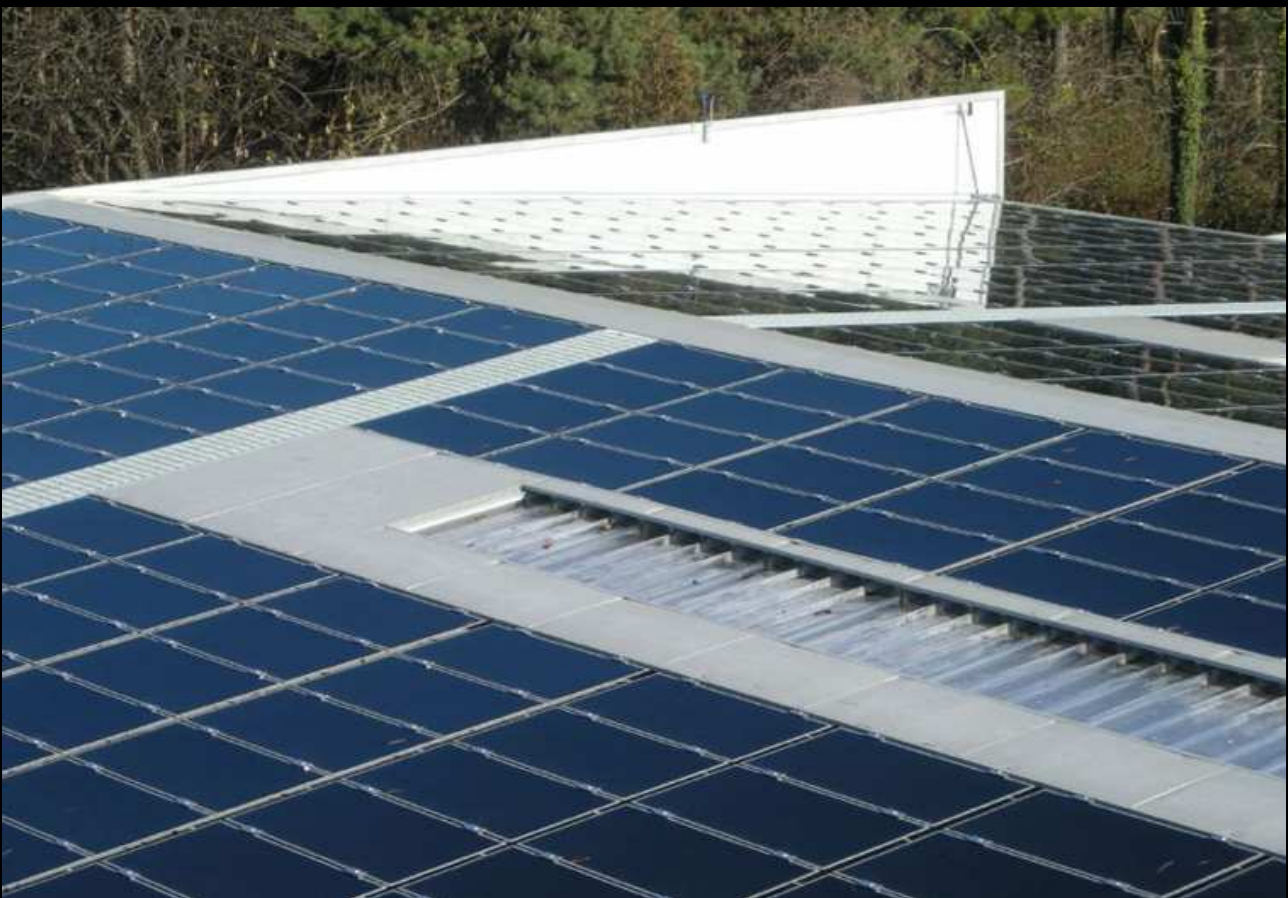
L'impianto terminato e produttivo
