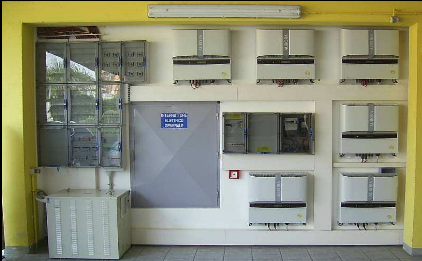
I quadri elettrici, gli inverter e il trasformatore
